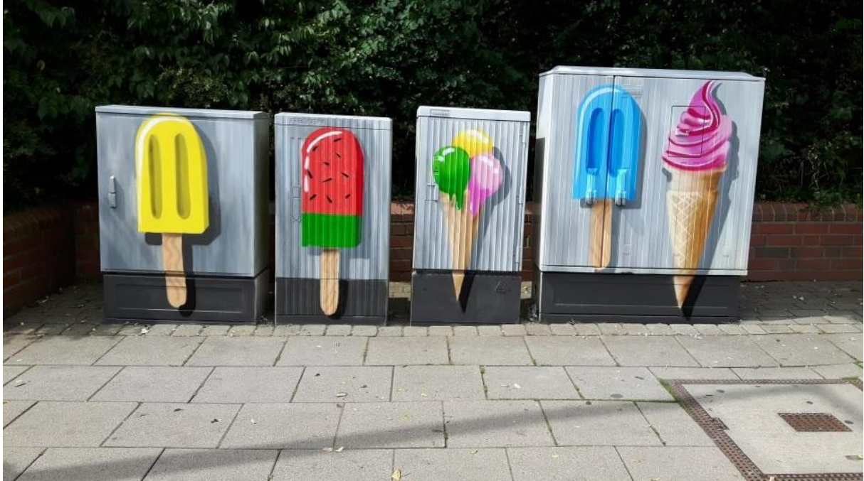
Schaltkästen in Lüneburg
